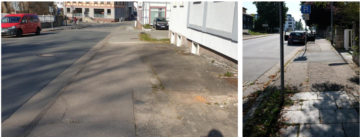
Sanierungsbedürftige Gehwege Dr.-A.-Hübenthal-Straße
