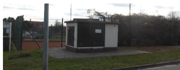
Trafostation Kreuzung Elisabethstraße – Am Stadion
