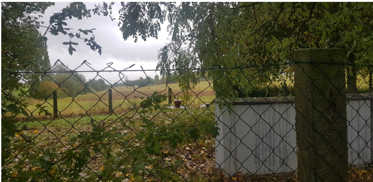
Hochbehälter und Verteilerkasten
