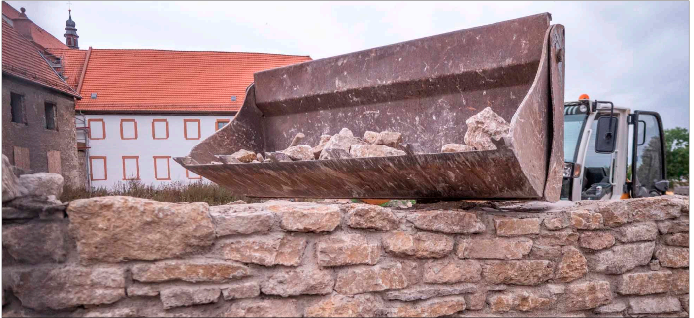
Die Worbiser Klostermauer, die wegen Baufälligkeit abgerissen wurde, wird nun wieder aufgebaut.
