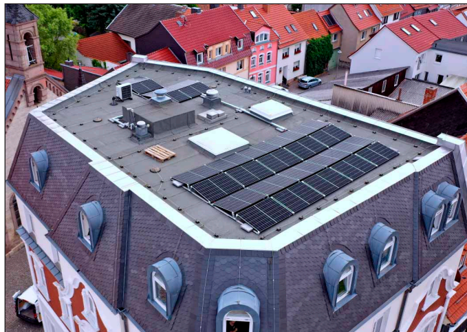
Das Flachdach des Verwaltungsgebäudes „Kaufeck“ in Worbis eignet sich besonders gut für die Installation einer PV-Anlage.
