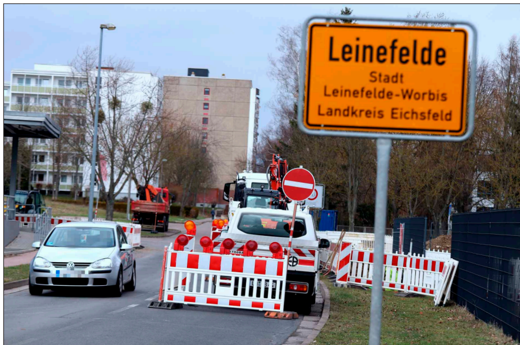
Wegen des Neubaus einer Trafostation in der Südstadt musste Anfang März auch die Leinefelder Kellerstraße mehrere Tage lang einseitig für den Verkehr gesperrt werden. Fotos: René Weißbach
