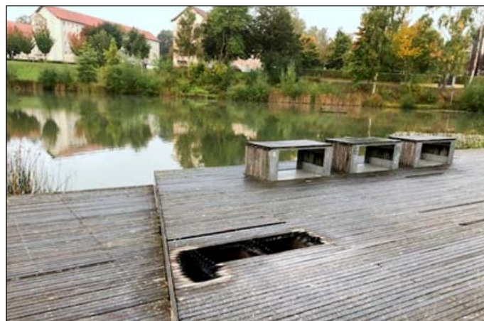
Große Teile des Holzsteges am Märtens Teich sind durch das Feuer komplett zerstört worden. Foto: Ordnungsamt
