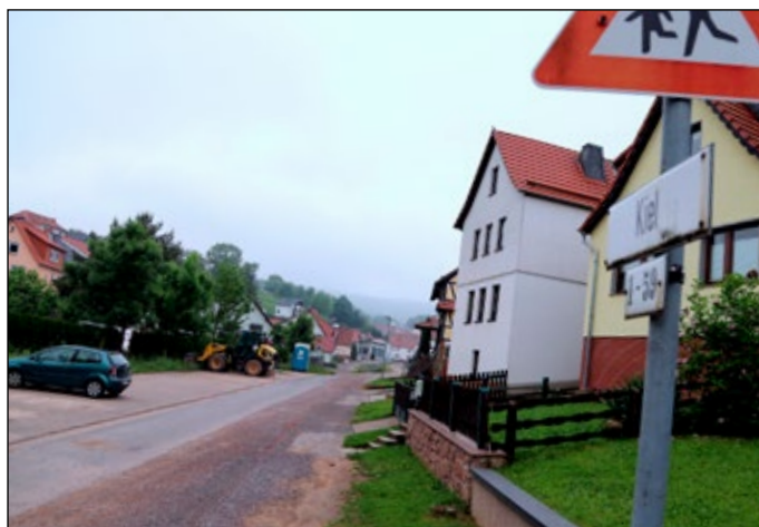
Durch die Kanalarbeiten des Abwasserzweckverbandes ist die Straße „Kiel“ derzeit in schlechtem Zustand. Foto: René Weißbach
