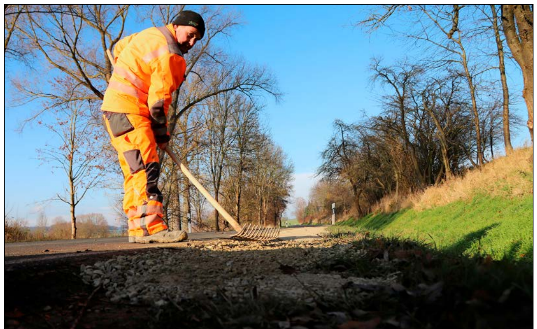
TSI-Mitarbeiter reparierten Anfang Dezember des vergangenen Jahres die arg in Mitleidenschaft gezogenen Bankette der Straße zwischen Breitenbach und Hundeshagen. Foto: René Weißbach
