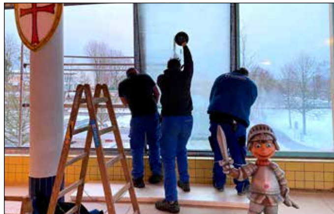
Die energetische Sanierung der Fensterfassade im Eltern-Kind-Bereich gehörte zu größeren Arbeitseinsätzen. Foto: Simone Haase
