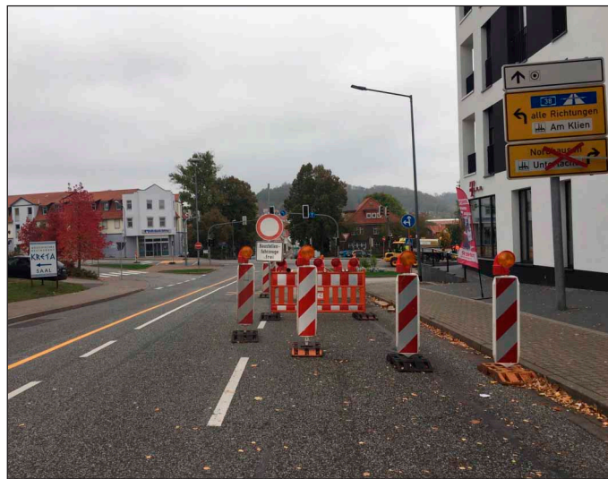
Im ersten Bauabschnitt blieb die Rechtsabbiegerspur der Kreuzung aus Richtung Breitenbach kommend gesperrt. Foto: T. Krchov
